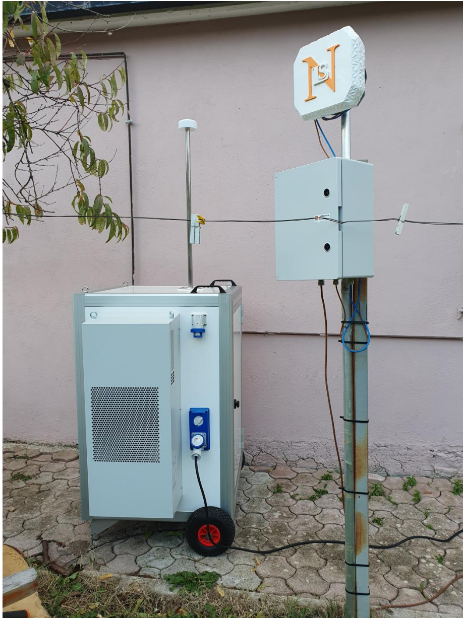
Figura 1 : centralina di monitoraggio
