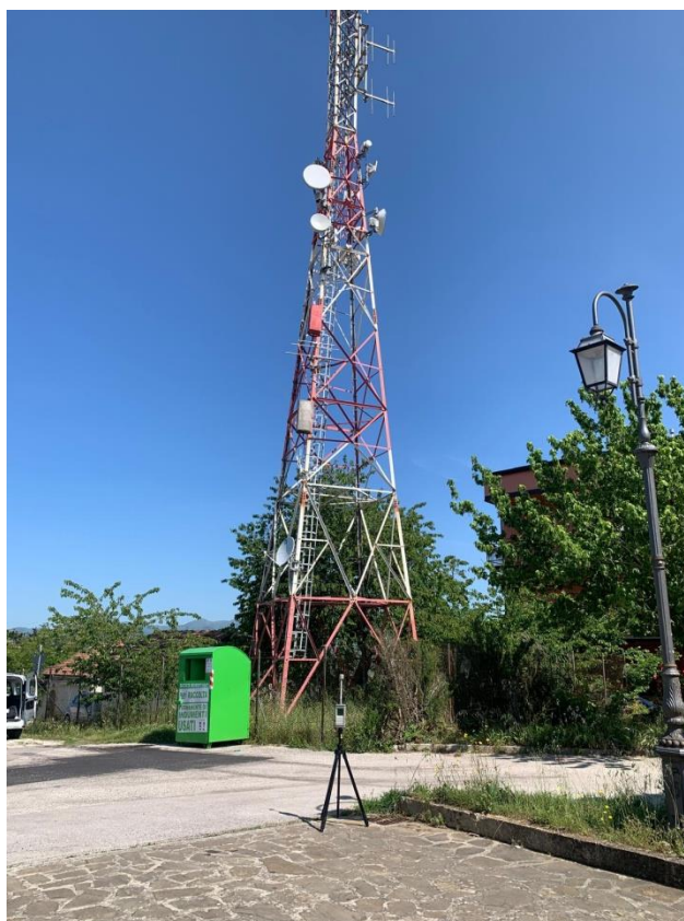
FIGURA 1: FOTO IMPIANTO DI TELEFONIA CELLULARE ESISTENTE
