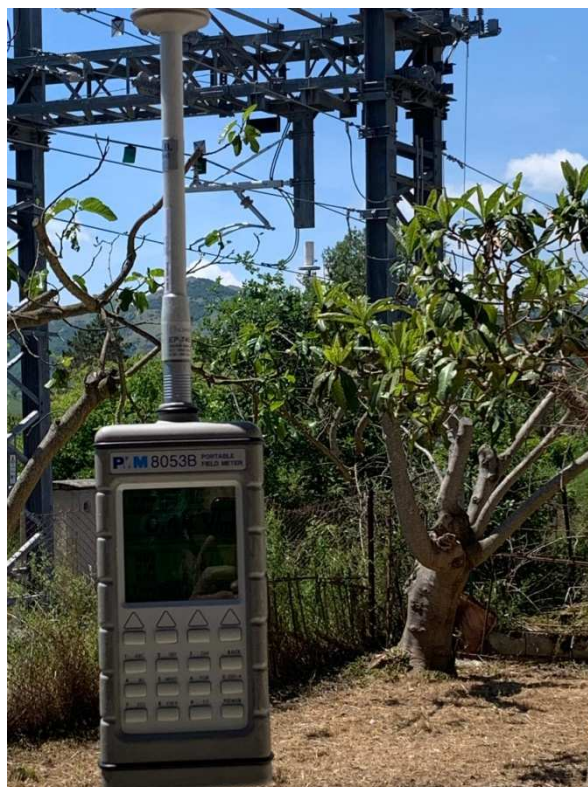
FIGURA 10: PUNTO DI MISURA 9
