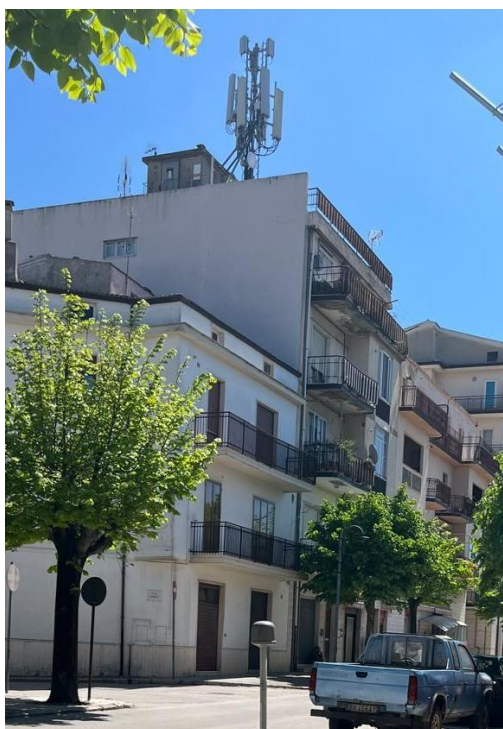
FIGURA 1: FOTO IMPIANTO DI TELEFONIA CELLULARE ESISTENTE
