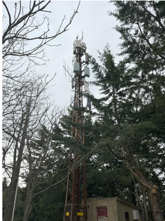
FIGURA 1: FOTO DELL'IMPIANTO RADIOTELEVISIVO ESISTENTE
