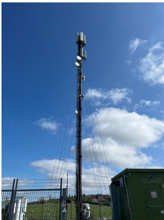
FIGURA 1: FOTO IMPIANTO DI TELEFONIA CELLULARE ESISTENTE
