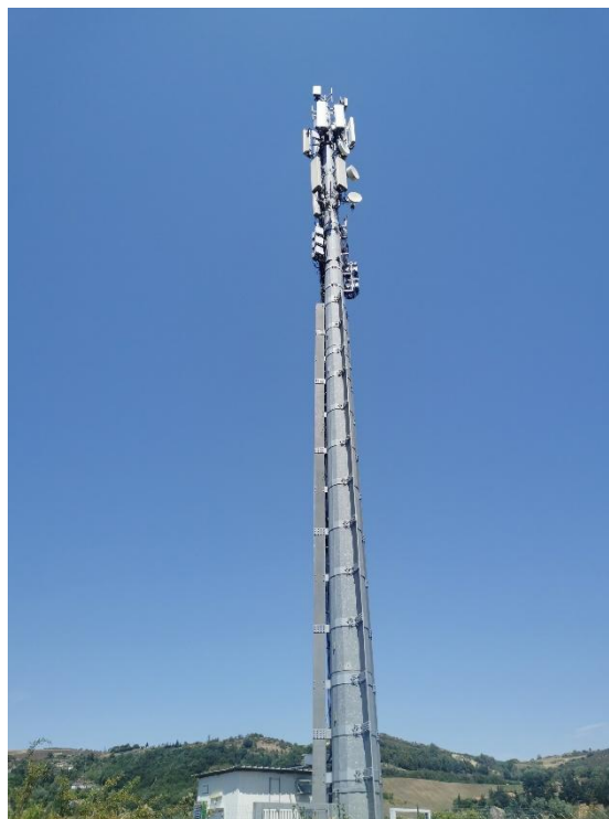
FIGURA 1: FOTO IMPIANTO DI TELEFONIA CELLULARE ESISTENTE
