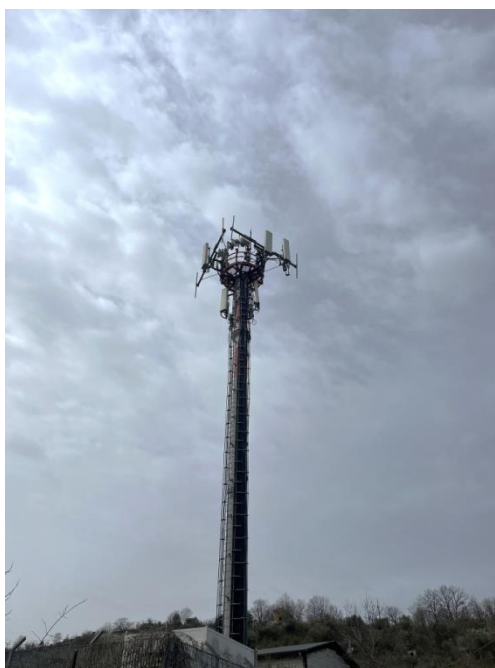
FIGURA 1: FOTO IMPIANTO 1 DI TELEFONIA CELLULARE ESISTENTE
