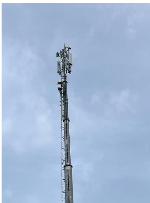
FIGURA 2: FOTO IMPIANTO 2 DI TELEFONIA CELLULARE ESISTENTE
